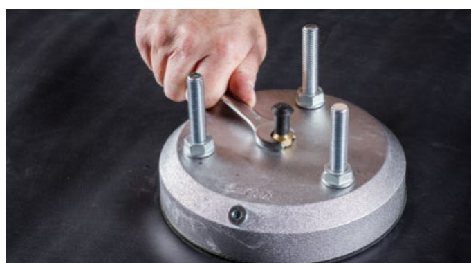
In die 2. Öffnung das Prüfventil einschrauben
